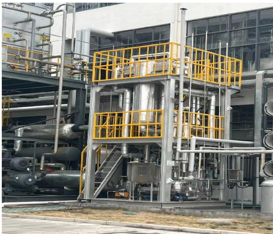
浙江晟创制药有限公司二氯甲烷液氮深冷装置现场照片
