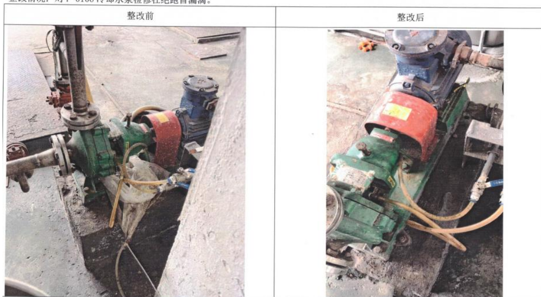
图 3.4-8 隐患排查整改照片
